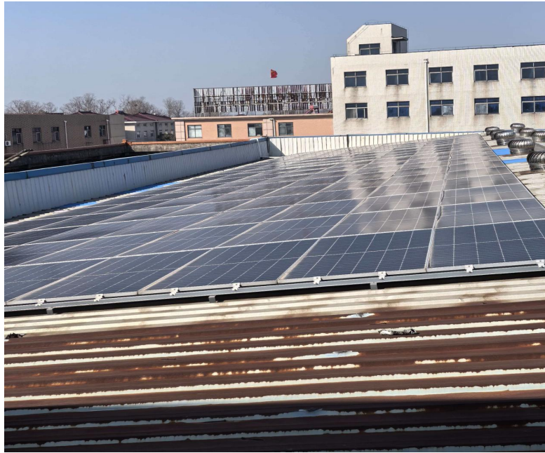
分布式屋顶光伏现场照片
